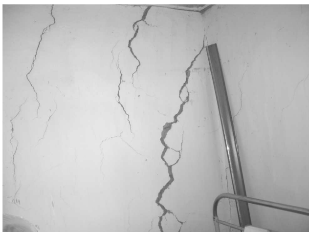
Рис.5. Вертикальные сквозные трещины на несущей стене.
