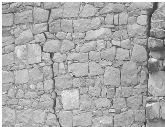
Рис. 3. Пример отрыва стен друг от друга, из-за плохой связи между камнями
