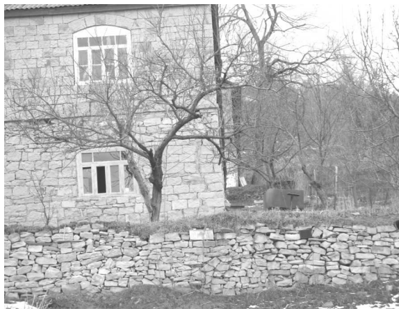
Рис. 4. Пример разрыва здания по вертикальному сечению.
