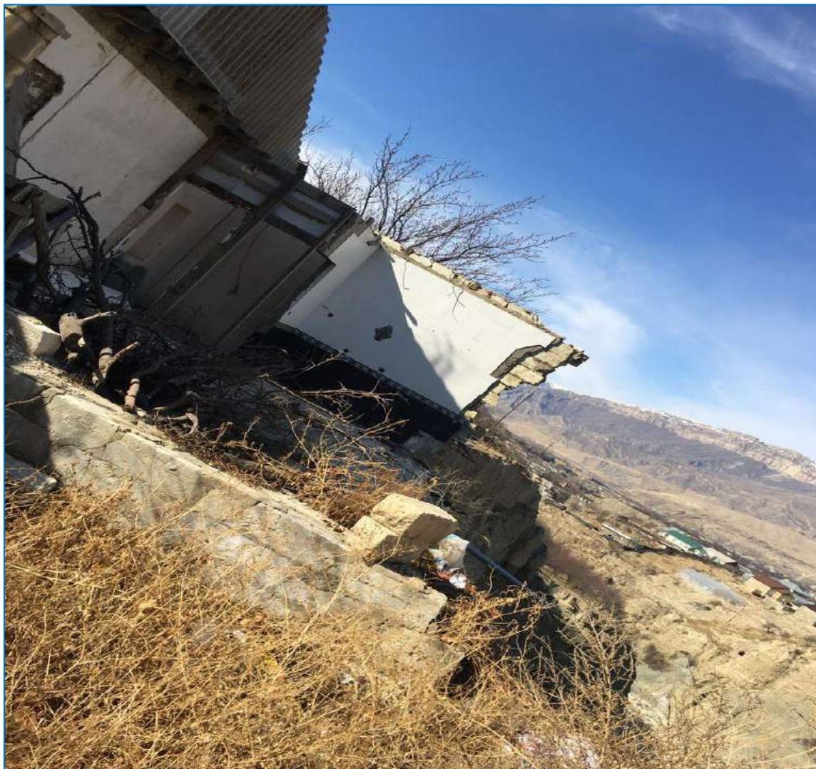
Рис. 4. Вид на обвалившиеся постройки
