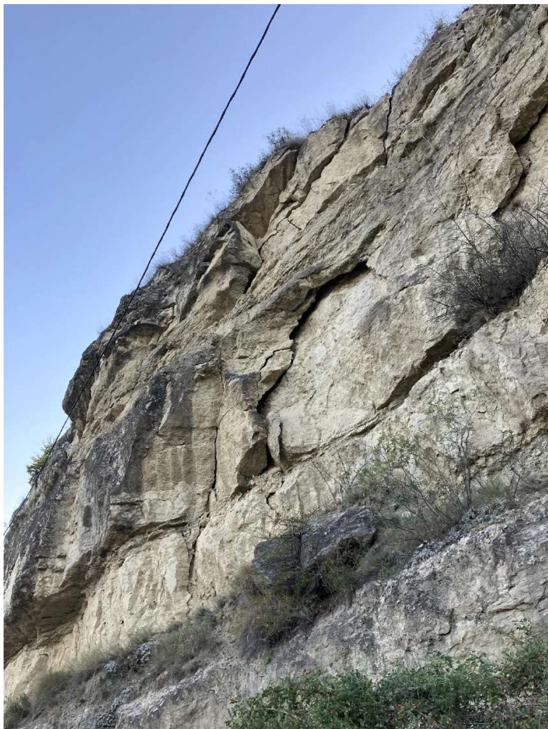
Рисунок 2. Фото неустойчивого массива с вертикальными отрывными трещинами.
